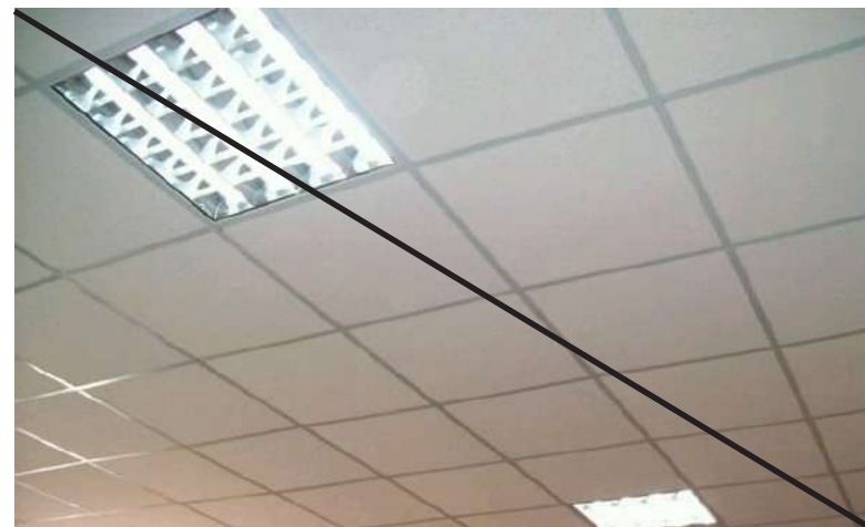
Плохо Открытые направляющие
